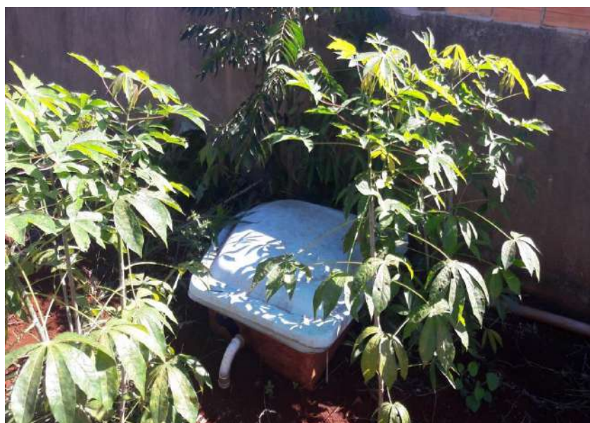
Casa de máquinas
