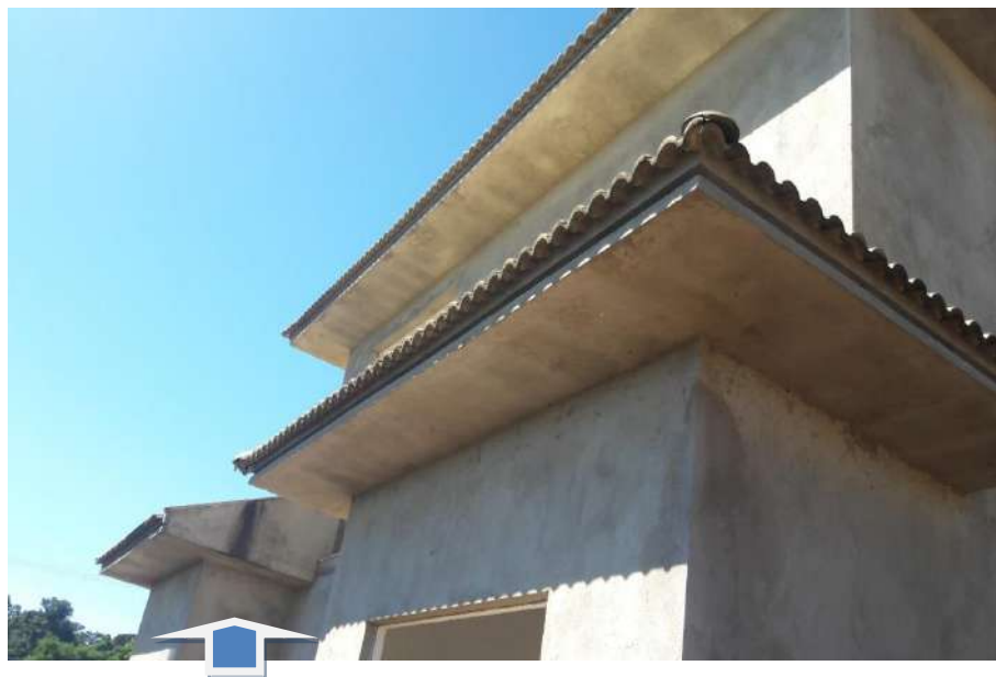
Detalhe emboço frontal/infiltrações
