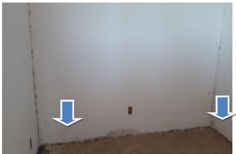
Detalhe de trinca junto às vigas invertidas
