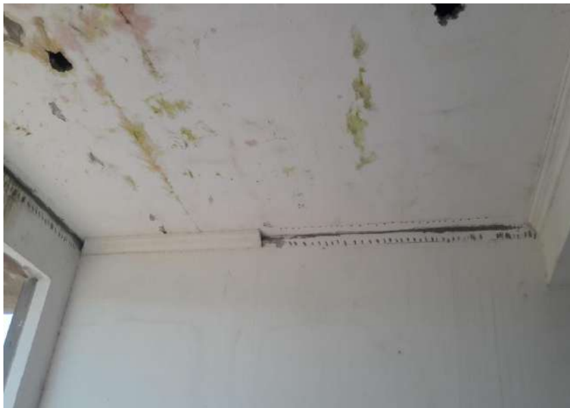
Detalhe de infiltrações e deslocamento de gesso no Hall/mezanino
