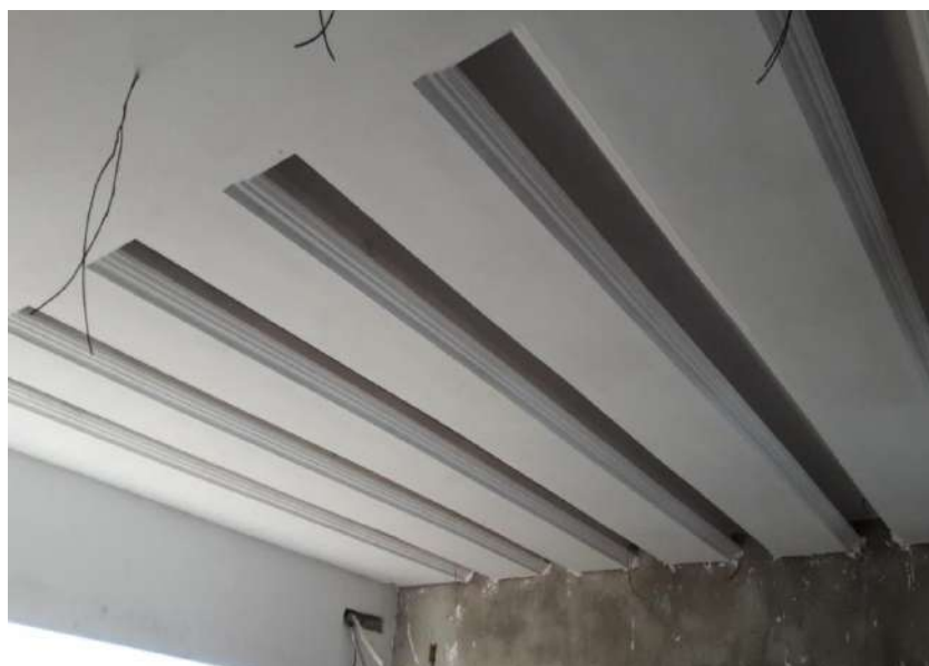
Forro em gesso rebaixado no estor
