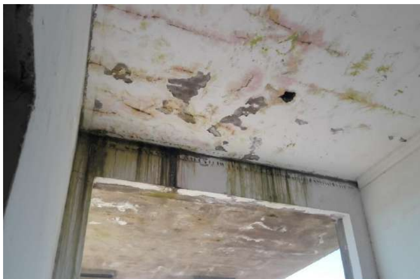
Detalhe de infiltrações no volume de caixa d'água/ar condicionado
