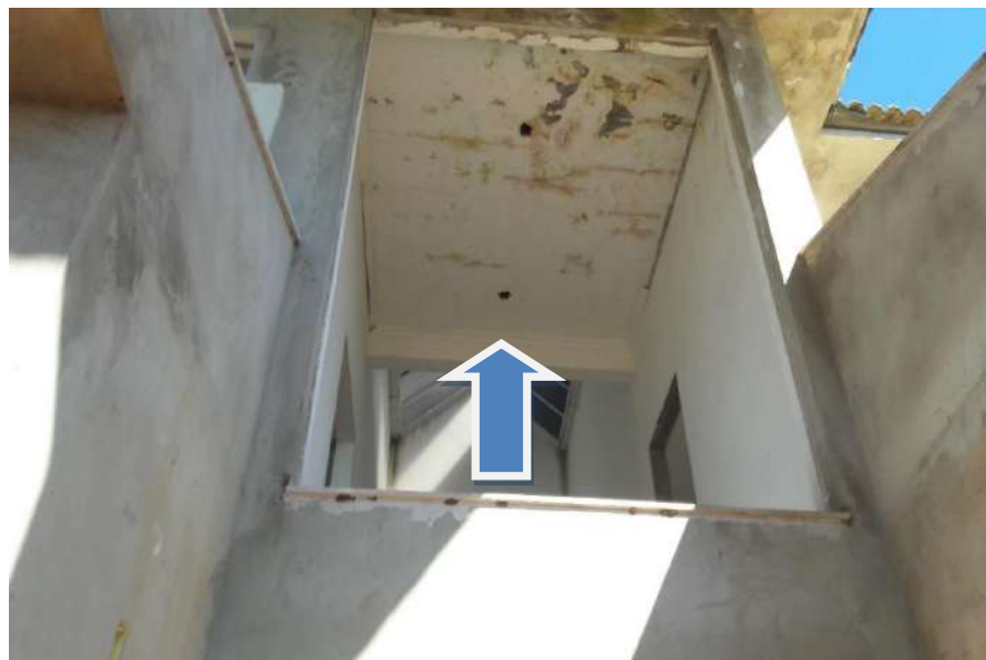
Infiltrações severas abaixo do volume de caixa d'água
