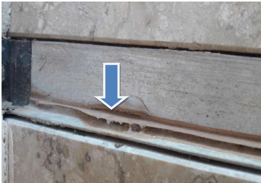
Detalhe de contramarco deformado
