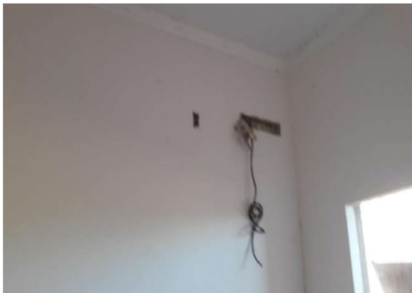
Detalhe de instalações de ar condicionado
