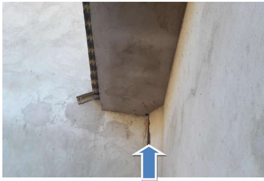
Detalhe de infiltrações
