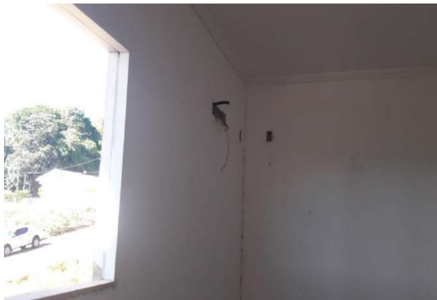
Demi-suíte/instalações de ar condicionado
