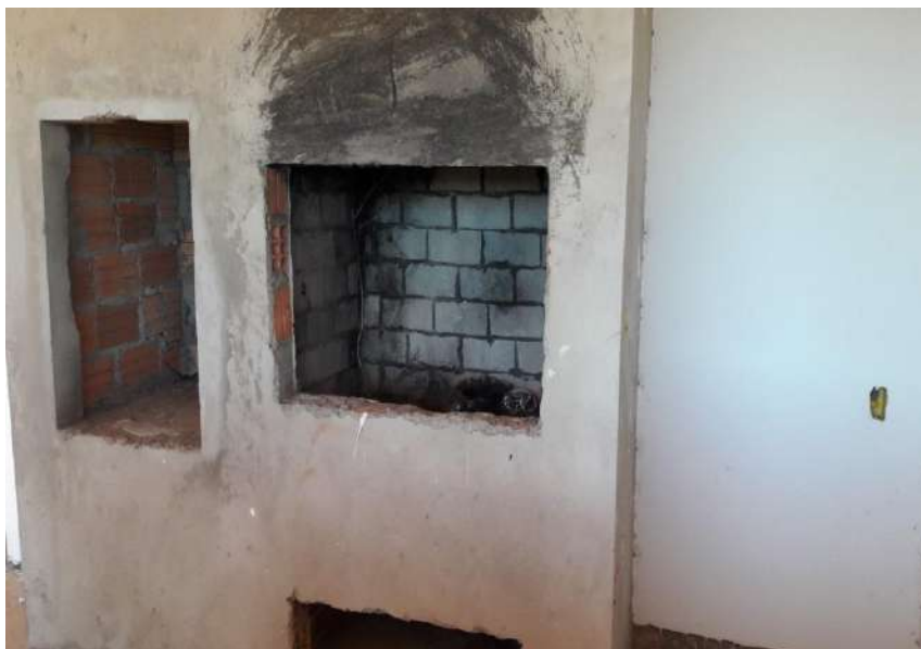
Detalhes da churrasqueira sem acabamentos/revestimentos
