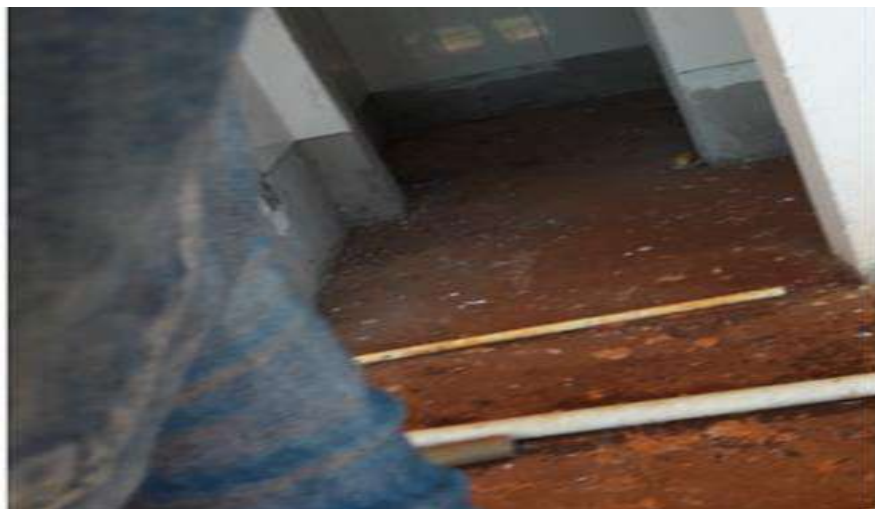
Detalhe sem finalização de azulejos e pisos do Banheiro/boudoir
