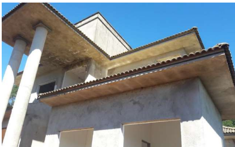
Emboço frontal e detalhes de infiltrações/umidade
