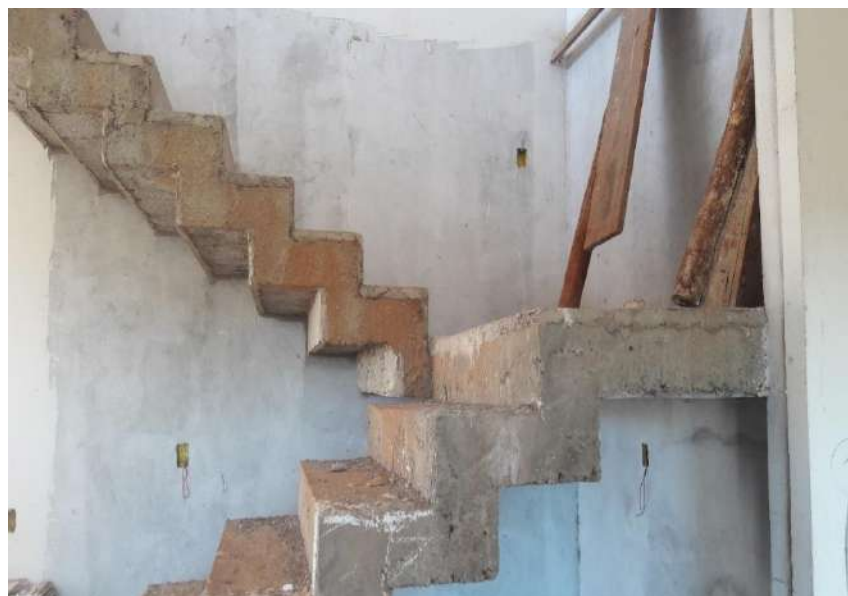
Detalhe das formas da escada/tratamento de ferragens/falta de regularização
