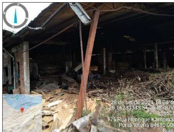
Estrutura comprometida no barracão 12.
